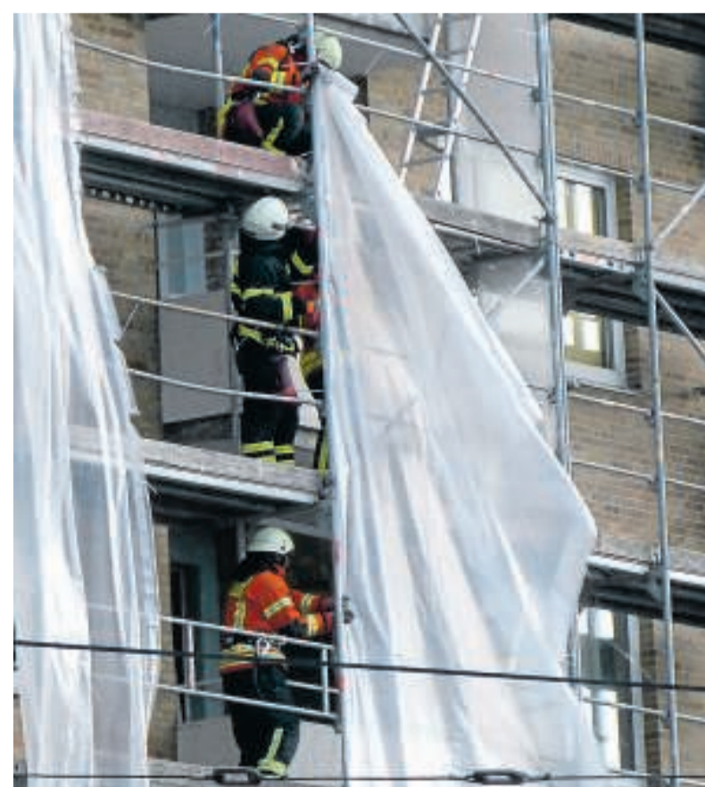
In der Langen Straße sicherten die Höhenretter am Samstagabend ein Gerüst und entfernten die vom Sturm zerfetzte Bauplane. Foto: Cornelia Steiner
